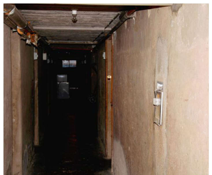
Le radon se concentre souvent dans les sous-sols, mais il peut aussi parfois remonter dans les étages. BLAISE DROZ
